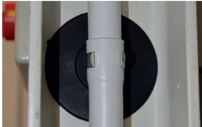
Befestigung von Leerrohren oder Leitungen direkt an Stahlträgern
